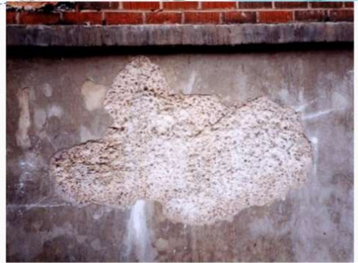
Spalling (Concrete flakes)
